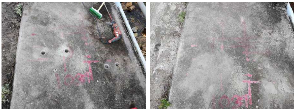
รูปที่ 4-9 รูปการซ่อมคืนสภาพจากการเก็บวัสดุทดสอบกำลังคอนกรีต
