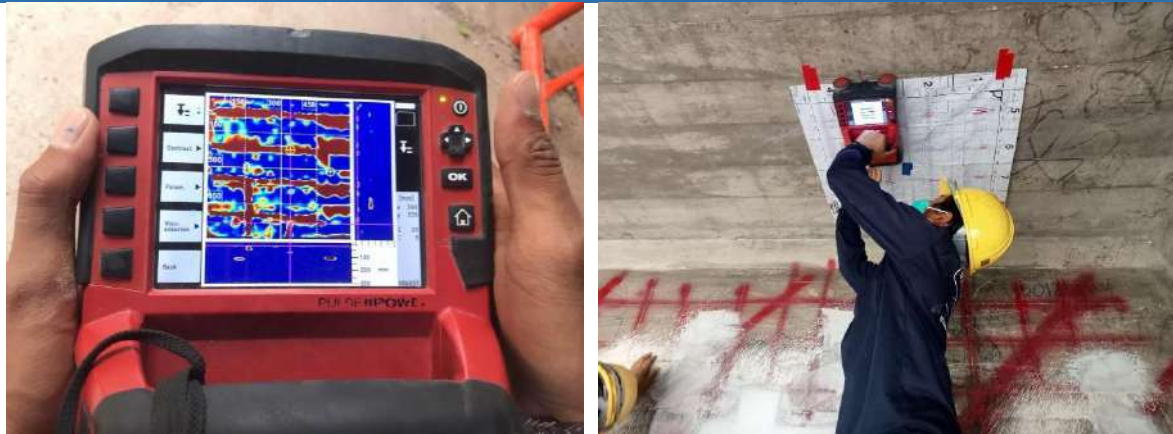
รูปที่ 3-10 ตัวอย่างการสแกนโครงสร้างด้วยเครื่องมือ Ground Penetrating Radar
