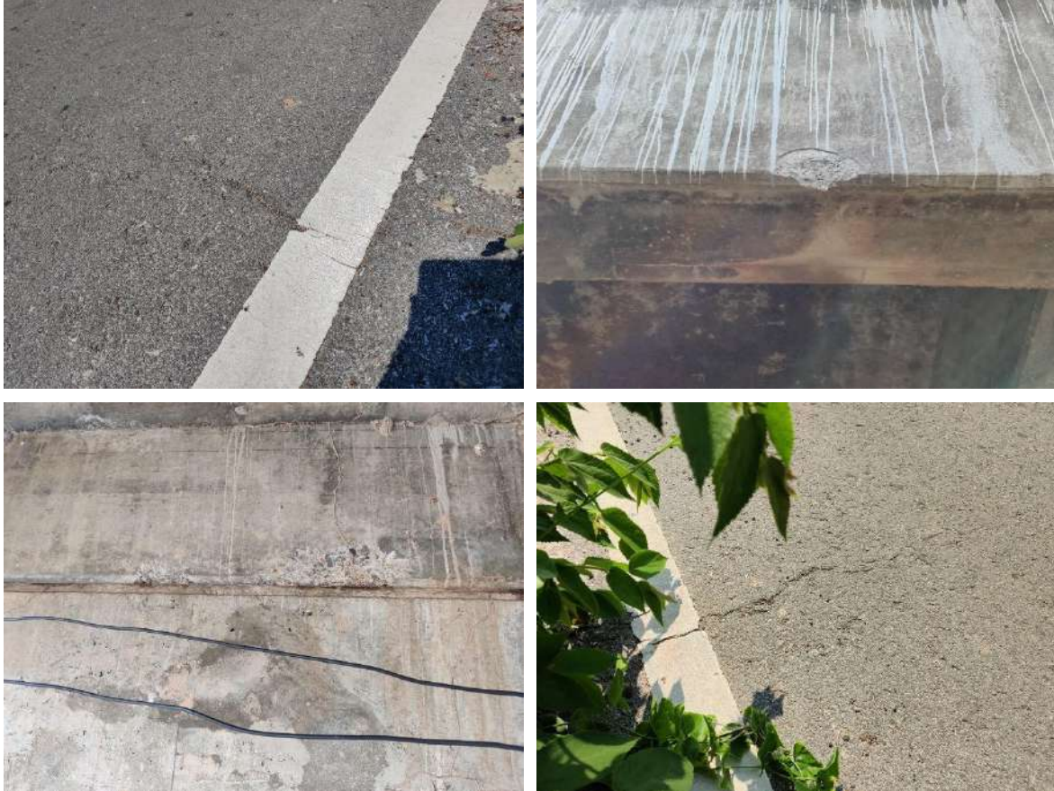
รูปที่ 6-4 ตัวอย่างบางส่วนของภาพความเสียหายของสะพาน
